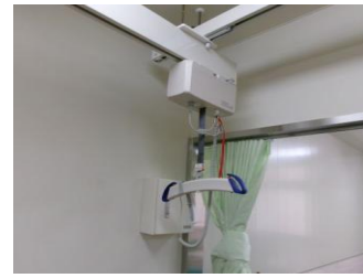
＜天井走行リフター＞ 居室ほかトイレ、浴室に設置しています。
